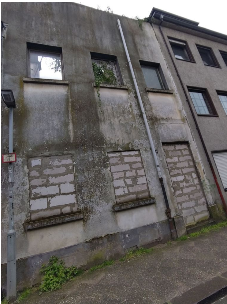
Mittelstr. 48: Ruine mit frei stehender Fassade, der Witterung ausgesetzten Mauern und Fenstern, starker Widerspruch zur Festsetzung im Bebauungsplan und Belastung des Ortsbildes
